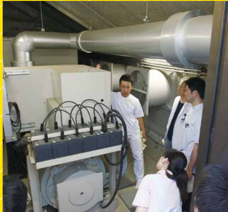
自家発電機・ボイラー
